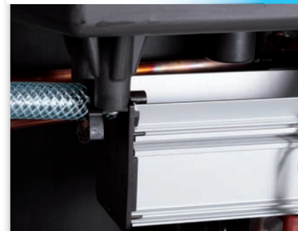
Sistema de evaporación de la condensación
