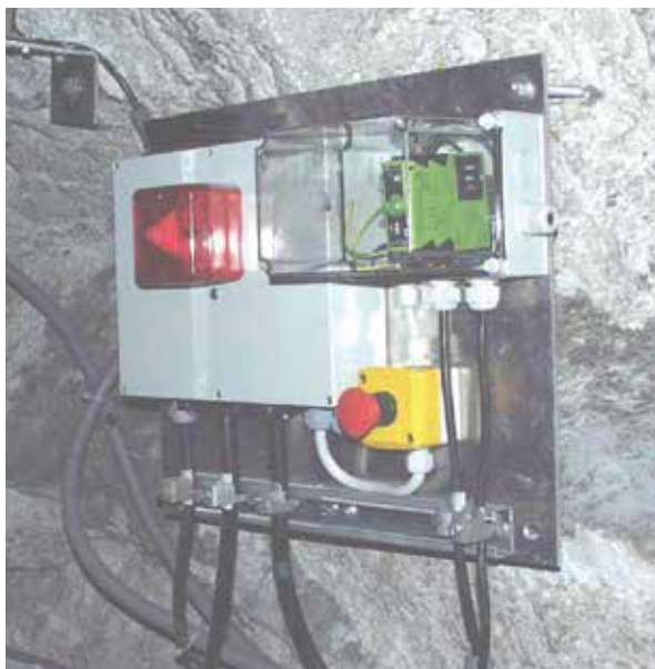
Fig.: Luce flash compatta utilizzata per un'apparecchiatura di sicurezza in una galleria. Il range di tensione di alimentazione pari a 70–264 V AC e 73–140 V DC supporta sia l'alimentazione con tensione di rete che quella della batteria d'emergenza
