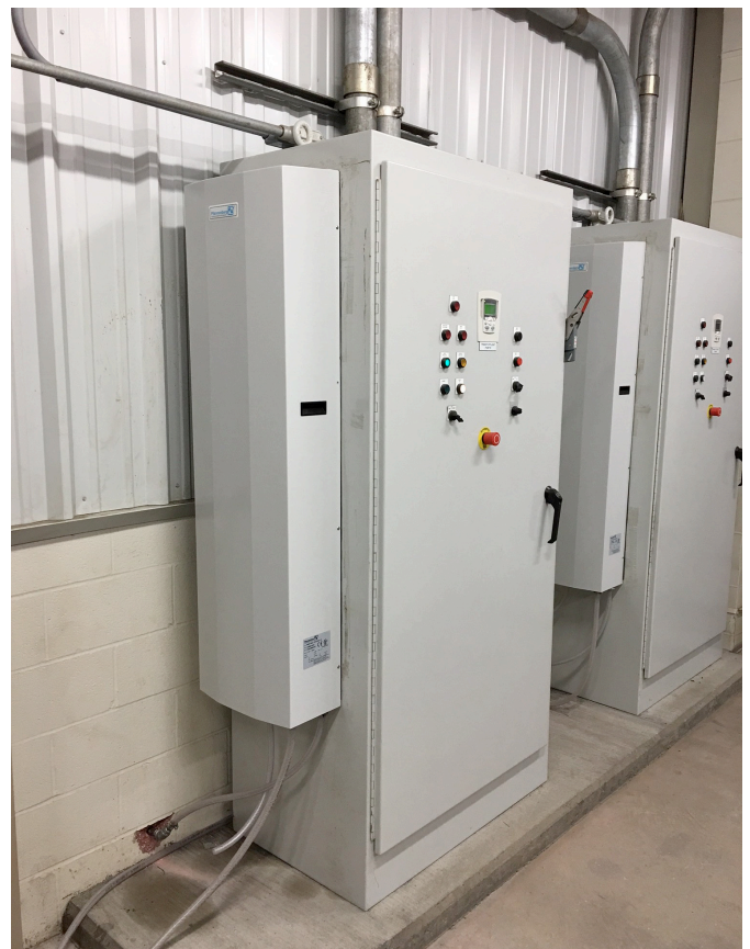
Luft-/Wasser-Wärmetauscher von Pfannenberg im Schaltschrank einer Hebeanlage in einer Abwasseraufbereitungsanlage
